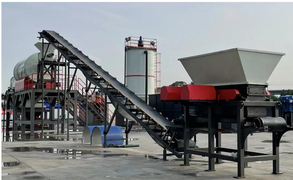
杭钢项目淋洗设备实景图
