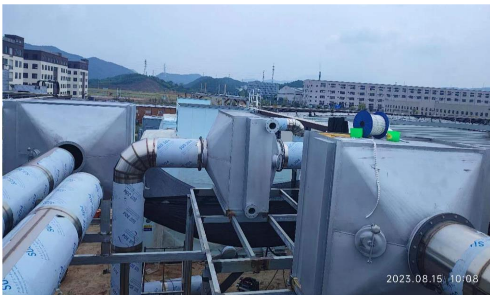
浙江坤孚 DMF/甲苯回收治理工程
